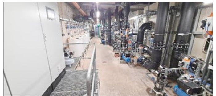
Technikraum des Freibades
