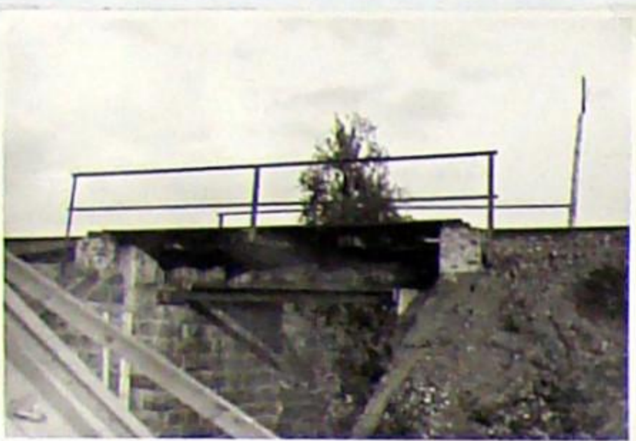
Nach 100 Jahren Eisenbahnbetrieb hatten die Fundamente und Flügelmauern der kleinen Blechträgerbrücke die Standfestigkeitsgrenze erreicht. Für das Gleis galt eine Höchstgeschwindigkeit von 5 km/h.
