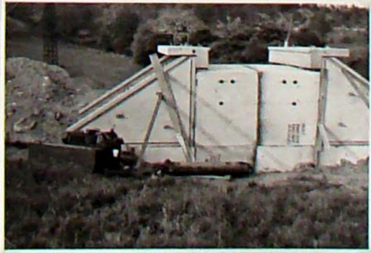
Einige Tage später sind Arbeiten zum Verbinden und Verfugen der Betonbauteile im Gange. Davor steht die Hydraulikpumpe und die Zylinder für den Einschub liegen dabei.
