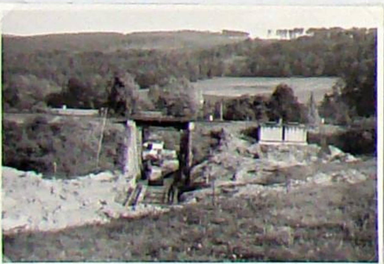
Die Einrichtung der Baustelle für den Einschub der neuen Unterführung hat schon begonnen. Die Gleitbahn aus Betonfundament und Schienen ist zur Aufnahme der Betonfertigteile bereit - 25.05.1988.
