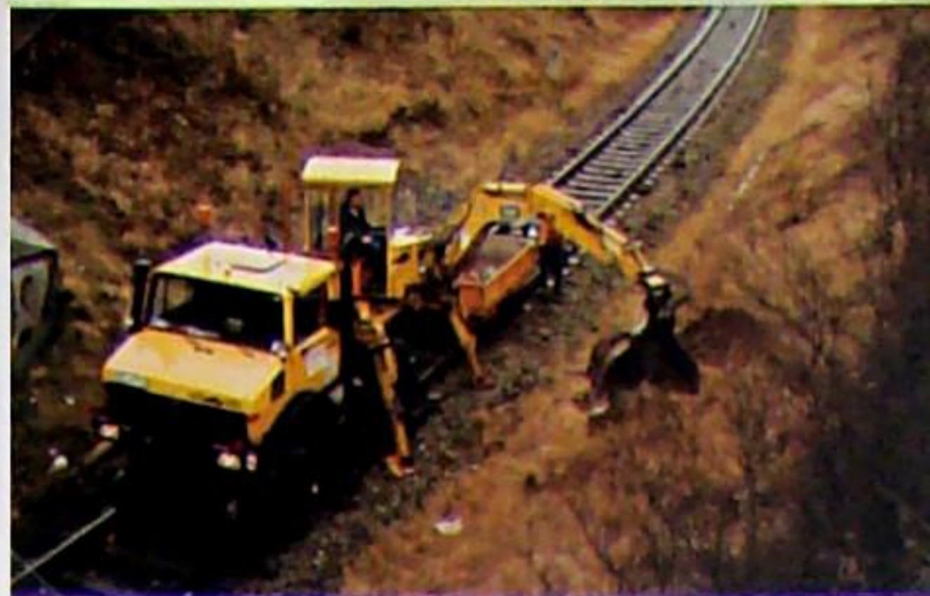
Am 13. 12.1999 erfolgte die Umsetzung des neuen Betriebskonzeptes zum Bahnhof Bad Berka, der Abbau aller bisherigen Signale, auch des BU-Überwachungssignals für die Stadtdurchfahrt.
