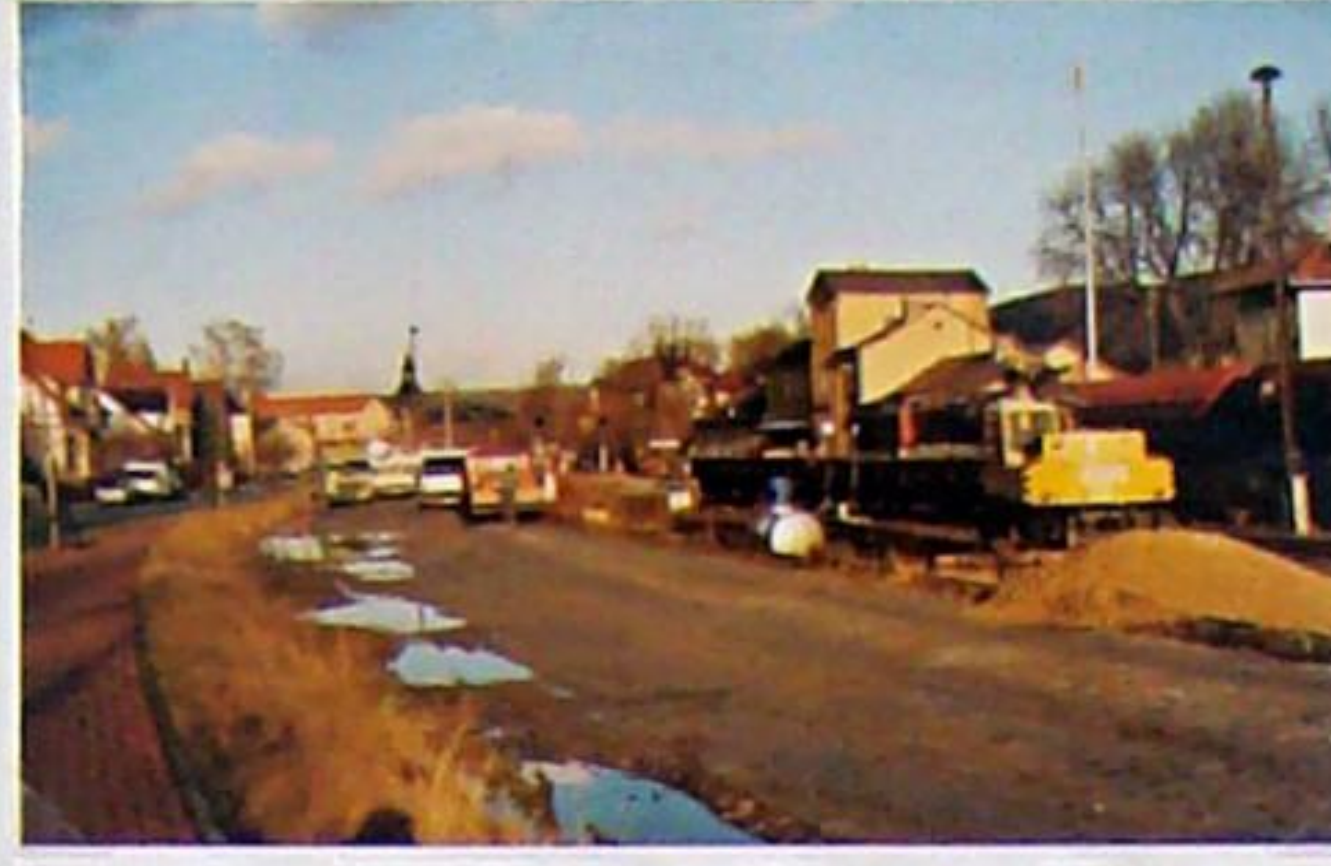
Gleisbauarbeiten am 14.12.1999 in Bad Berka, rechts im Hintergrund die bereits geleerten Schotterwagen
