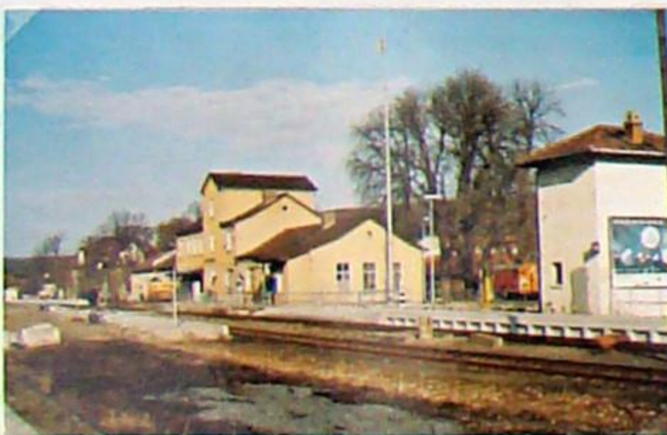
Bahnhof Bad Berka am 28.2.2000: Der Behelfsbahnsteig ist noch in Betrieb, Bahnsteig 1 und 2 teilweise fertig gestellt, der Hausbahnsteig wird gerade mit Bagger abgebaut.
