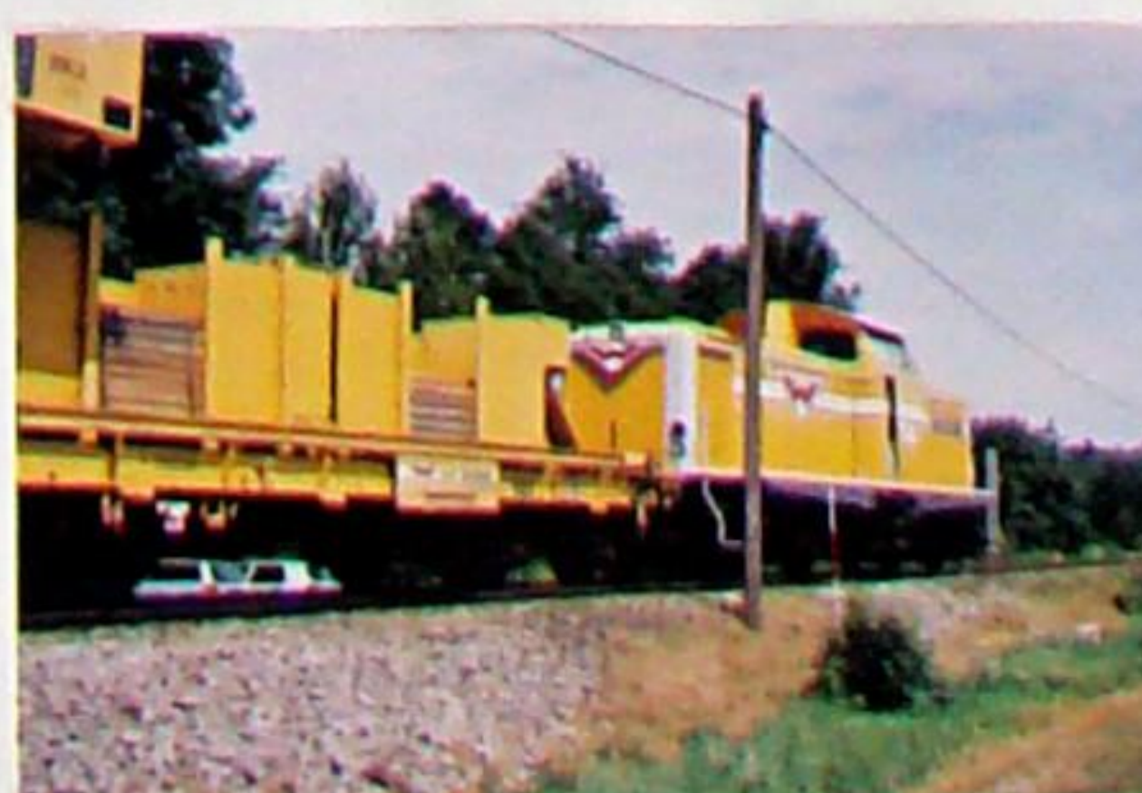
Zwischen dem 05.07. und 09.08. 2002 baute die Firma Wiebe das Streckengleis zwischen km 20,0 und der „Hansen“-Brücke einschließlich Unterbau völlig neu. Die Wiebe.LOK 3 wartet am Sportplatz Bad Berka auf den Abtransport der Altschwellen.
