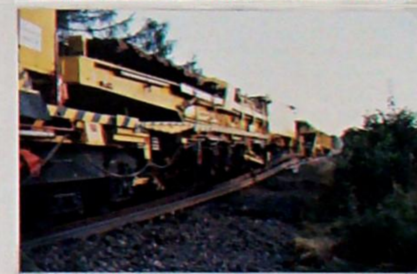
Die Schwellen-Umbaumaschine von vorn – links. Oben die ausgebauten Stahlschwellen und davor die Betonschwellen. Das hintere Drehgestell dient nur dem Transport. Der Schwellenaustausch erfolgt über Greifketten nach oben. Die neuen Schienen werden der zweiten M. nach innen zugeführt.
