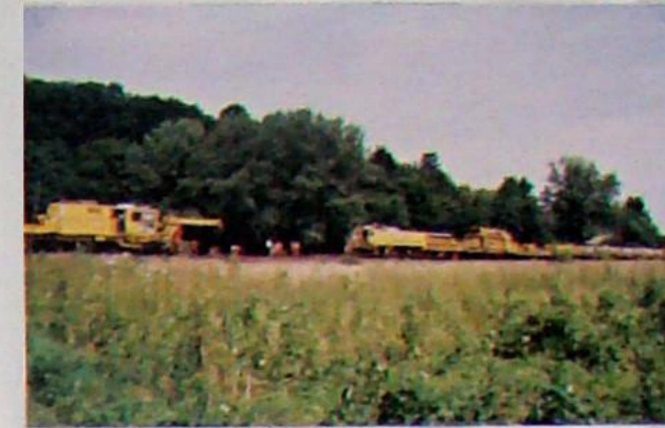
B. B 12.07.2002 – Arbeitsrichtung v.l.n.r. Die rechte Umbaumaschine fährt vorn auf dem alten Gleis und hinten auf dem Schotterbett. Dazwischen werden die alten Schienen gelöst und die Schwellen neu gegen alt getauscht. Die neuen Schienen werden der linken M. zugeführt. Diese werden von dieser verlegt um selbst darauf zu fahren.
