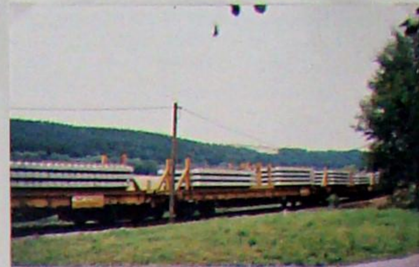
Am 10.07.2002 stehen vor dem Radweg-BO am Sprengstofflager die neuen Betonschwellen (Oberbau W) bereit. Über die seitlichen Schienen an den Wagen transportiert ein Portalkran alle Neu- und Altstoffe zur und von der Umbaumaschine.
