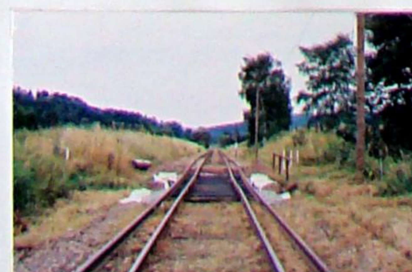
Am 07.07.2002 ist der Bahnsteig und die Zugangsbrücke am ehem. Haltepunkt Dammbachsgrund (re. zw. Geländer und Mast) total zugewachsen. Nach dem Ausbau der Strecke gab es erneut Hochwasser. Erst zum Jahresende 2003 wurde das Bachbett beräumt sowie ein Durchlass und die Zugangsbrücke ausgebaut.
