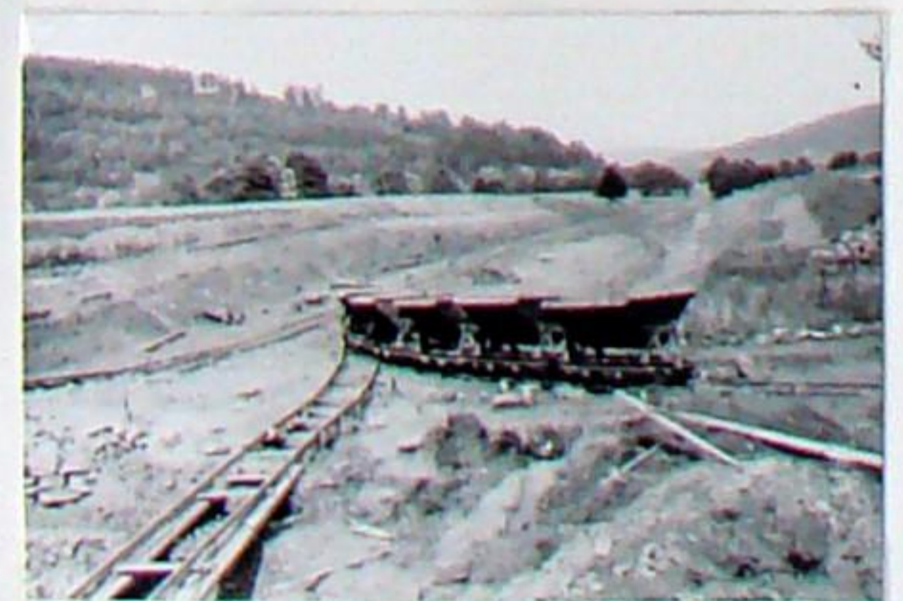
Zur Verlegung des Streckengleises von der Straße, musste 1930 am späteren BÜ Dammbachsgrund beginnend, ein Einschnitt in Richtung Bad Berka hergestellt werden. Der Aushub wurde mit Feldbahnkipploren abtransportiert.
