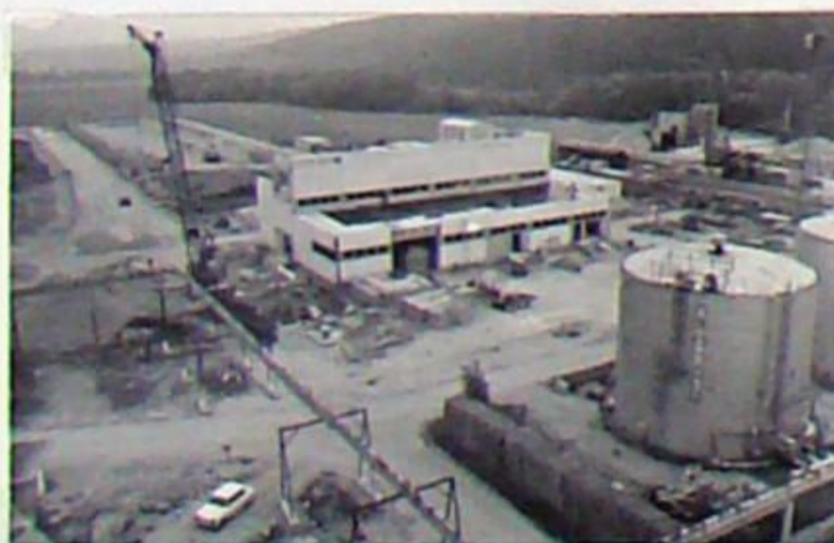
Kohleheizwerk Tannroda, Kesselhaus im Bau 1983 rechts die Heizölbunker, die 1984 außer Betrieb gingen
