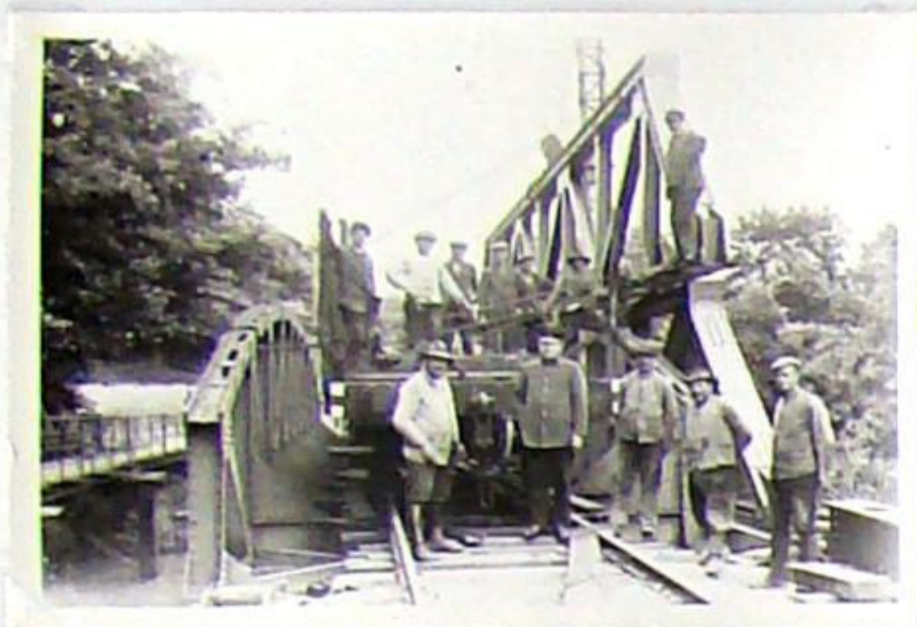
Der Umbau der Ilmbrücke in Richtung Blankenhain begann mit dem Abladen der neuen Fachwerk-Brückenträger um 1926
