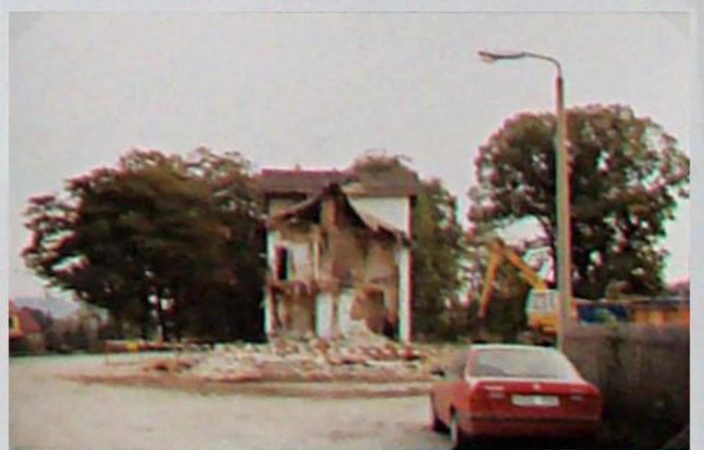
Nach drei Tagen Abriss gab es vom alten Bahnhofgebäude nur noch spärliche Schuttreste. Am ersten Tag, dem 22.9.1994, waren die Arbeiten schon weit fortgeschritten.
