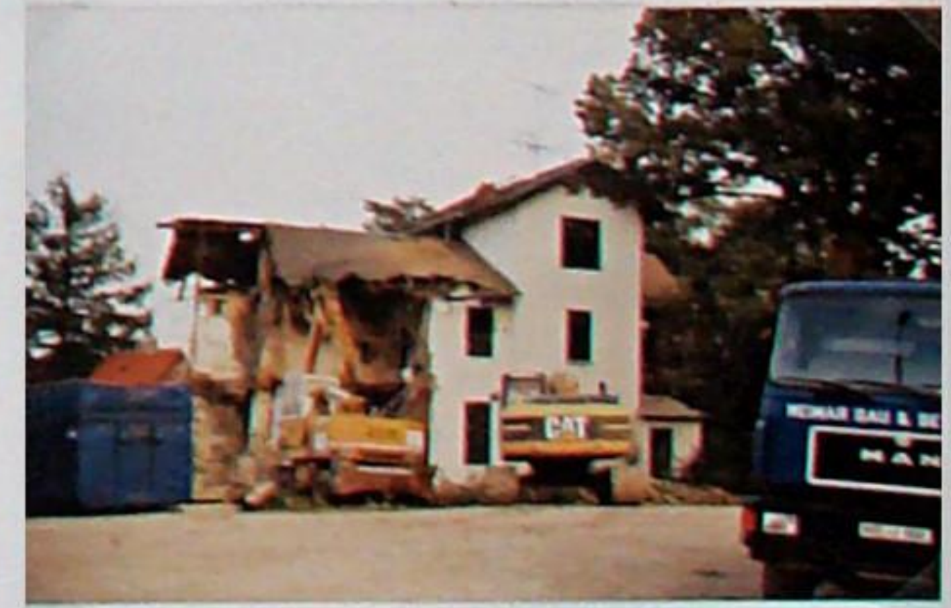
Nach drei Tagen Abriss gab es vom alten Bahnhofgebäude nur noch spärliche Schuttreste. Am ersten Tag, dem 22.9.1994, waren die Arbeiten schon weit fortgeschritten.
